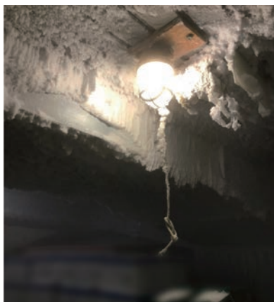
超冷凍庫交換前
